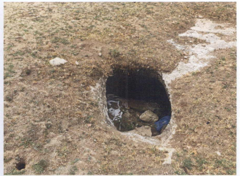
Üst örtüsü çölmüş mekanın içi
